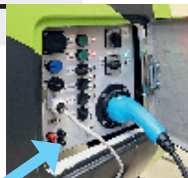
Электролизер производит из воды до 20 кг водорода в сутки, потребляя порядка нескольких киловатт — как большая электроплита. Затем водород подается на заправку.
